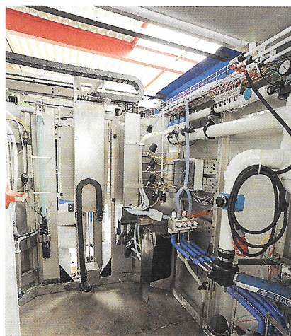
Blick in den Technikraum: Die Software mit KI verspricht eine präzisere Zitzenortung.
